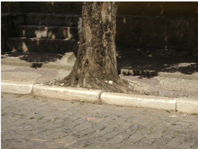
Foto 9: Conflito por gola(calçamento) na rua Gomes Barbosa. Não há espaço para a gola do alfeneiro devido ao estreitamento da calçada.
