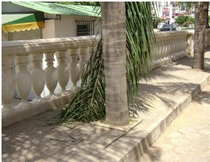
Foto 5: Conflito por tráfego na avenida Bueno Brandão, em que a calçada é estreita e ainda obstruída pela queda do ramo da palmeira.
