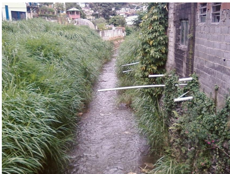
Foto 5: Vista da Travessa Simoninni para o Ribeirão São Bartolomeu. As casas são construídas praticamente dentro da calha do rio e possuem canos que desembocam dentro da mesma. Fonte: Acervo particular de Carolina Lemos Ferreira - 25/01/2012.
