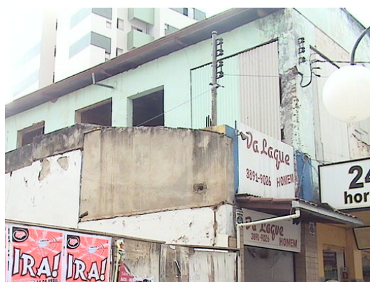
Figura 6: Deterioração de antiga residência no Calçadão. Fonte: foto de Cecília C. Almeida (2006).
