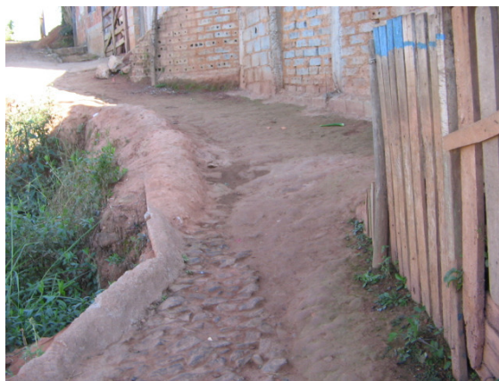
FIGURA 6 – Parte da rua do Contorno que desmoronou – 2006
