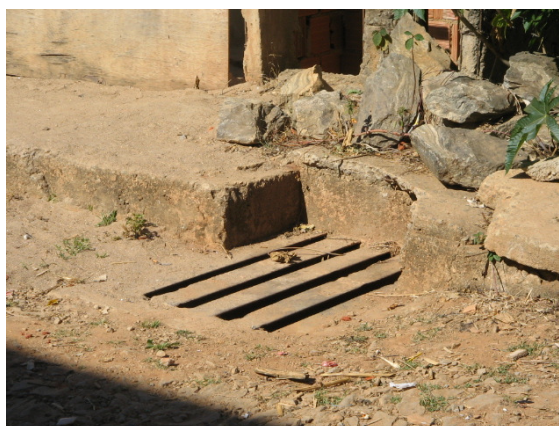
FIGURA 17 – Sumidouro na rua Dona Inês de Castro – 2006
