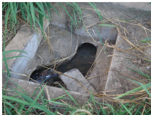
Fotografia 11: Caixa de Esgoto Aberta
