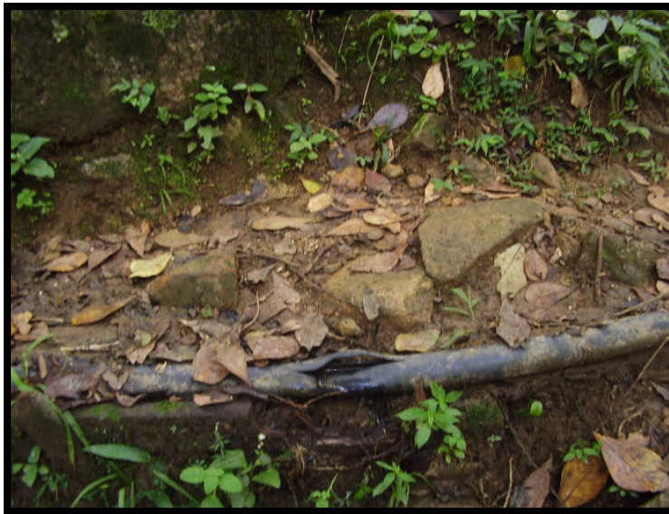
Foto 13b- Canos de captação de água danificado.
