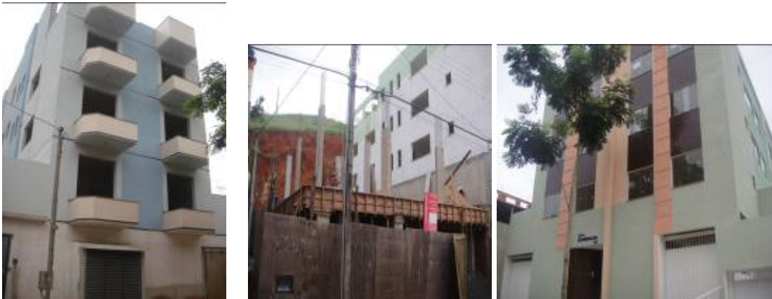
Figura 41 – Prédios ainda em fase de construção em João Braz, na Rua Tiradentes.
