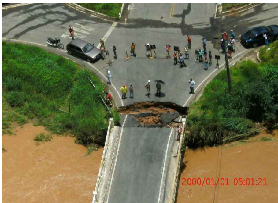
Figura 2: Uma das cabeceiras da ponte do bairro Rasa cedeu após a enchente de dezembro de 2008.
