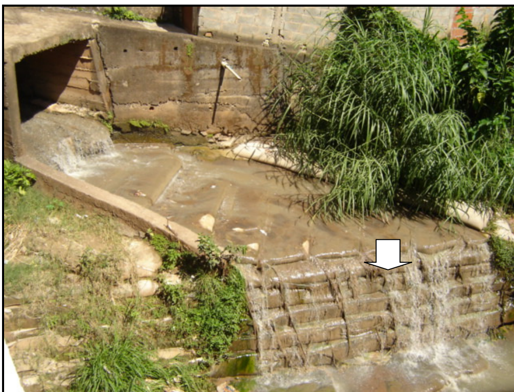
Figura 3: Foto do esgoto sendo lançado diretamente no Córrego São Bartolomeu Registro feito pelo autor. Data: 12/04/2006
