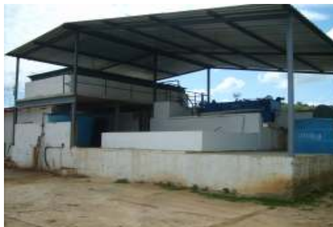
Figura 10: Sistema de tratamento de efluentes da Cooperativa de Laticínios Vale do Mucuri.
