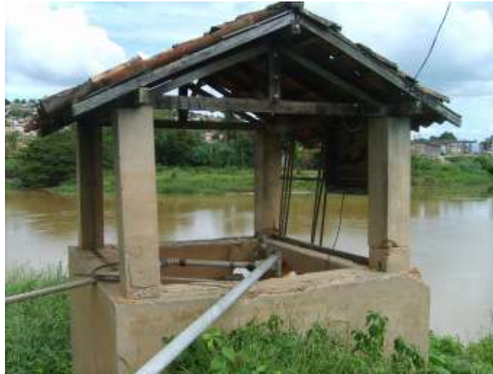
Figura 06: Sistema de captação de água da Cooperativa de Laticínios Vale do Mucuri Foto: Hollerbach, Luiz F., Abril/2008.
