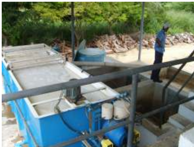
Figura 09: Estação de tratamento de efluentes, visto por cima, da Cooperativa de Laticínios Vale do Mucuri
