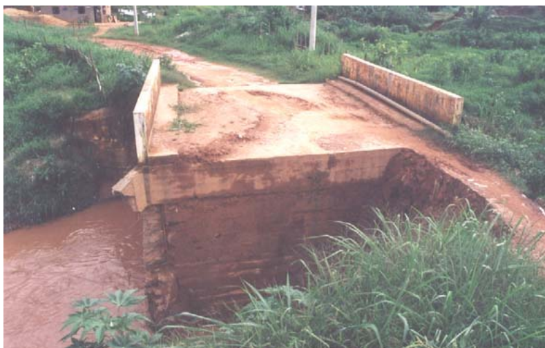
Figura 25. Ponte danificada do Bairro Amoras.
