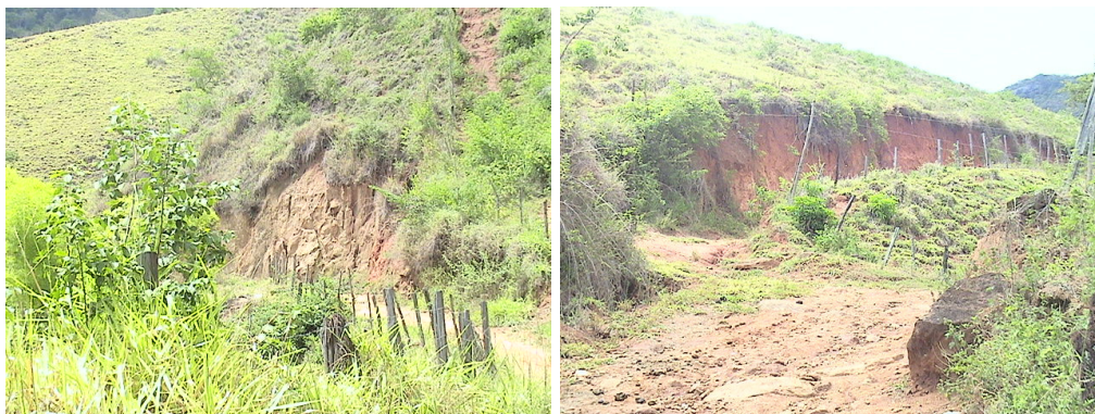
Figura 15: Cortes de estrada e aceleração do processo erosivo. Fonte: Pereira, 2006.
