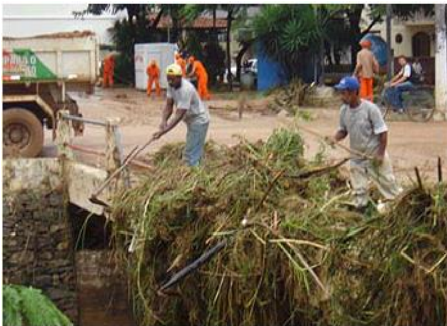
Figura 8 – Ponte danificada pela força das águas do ribeirão Ubá durante a inundação do dia 30/01/2008. Disponível em: http://www.acesa.com/cidade/arquivo/naregiao/2008/01/30-uba/galeria.php - Acesso em: 10 ago. 2013.
