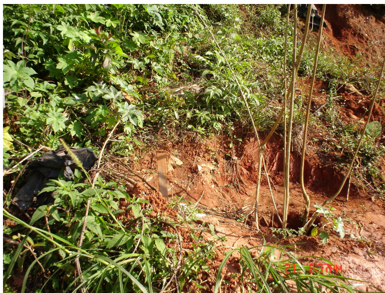
Figura 9 Abertura de orifício no solo para sondagem do talude. Fonte: TEIXEIRA, F.G. (2006)
