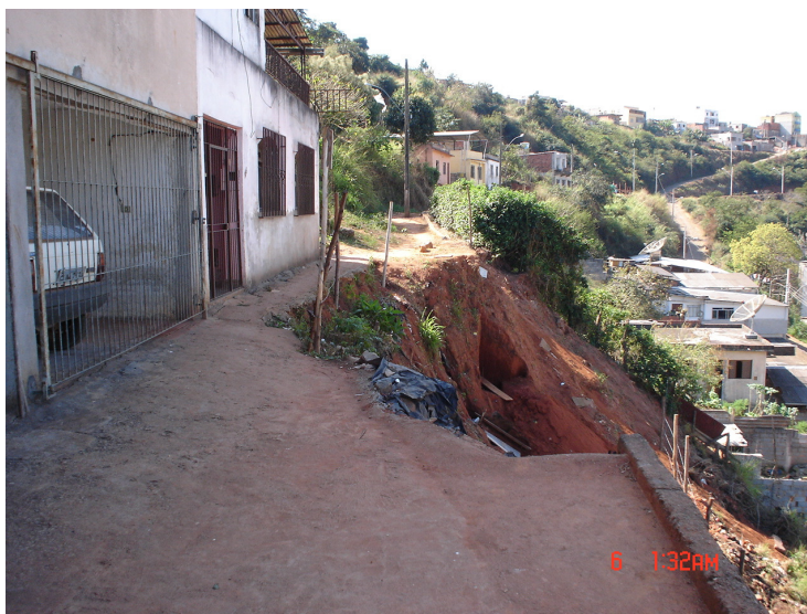
Figura 17. Passeio comprometido devido a deslizamentos situado acima do talude.
