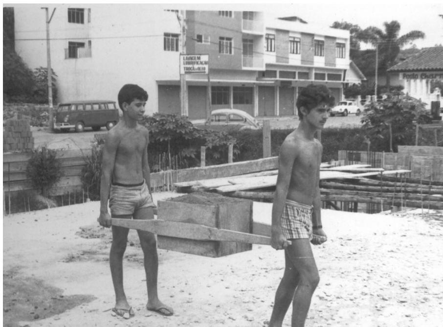
Figura C.7: Estudantes do Coluni-UFV trabalhando nas obras de construção do 2º templo Fonte: Arquivo histórico da Igreja Presbiteriana de Viçosa (1975)
