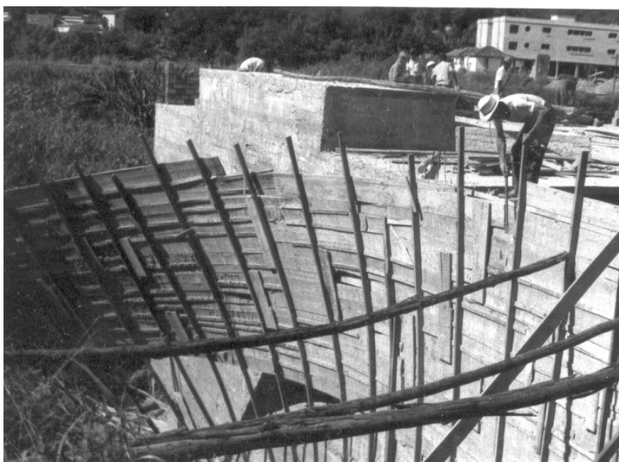
Figura C.4: Andamento das obras de construção do 2º templo Fonte: Arquivo histórico da Igreja Presbiteriana de Viçosa (1975)
