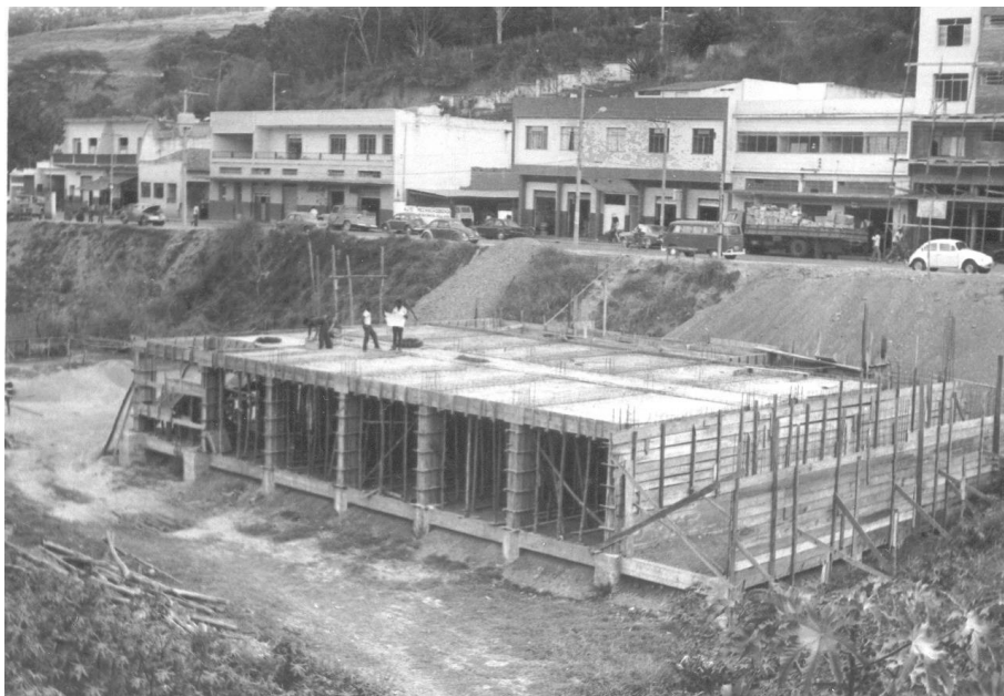
Figura C.3: Andamento das obras de construção do 2º templo Fonte: Arquivo histórico da Igreja Presbiteriana de Viçosa (1975)
