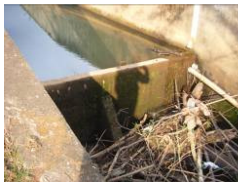
Foto 15 - Entulho carregado durante a última chuva.
