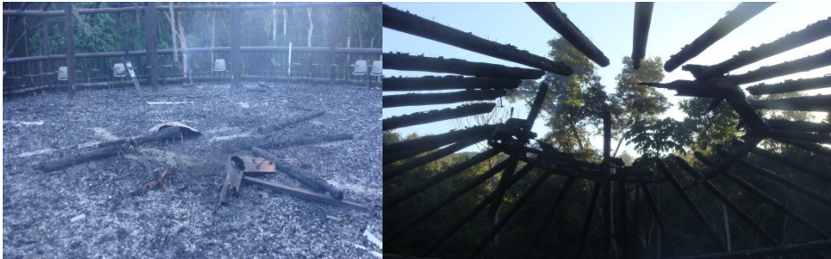
Figura 18 – Restos do incêndio Figura 19 – Estrutura superior danificada Foto: GEIA-Mata, 2007
