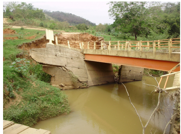
Foto 19 - Má alocação de ponte.
