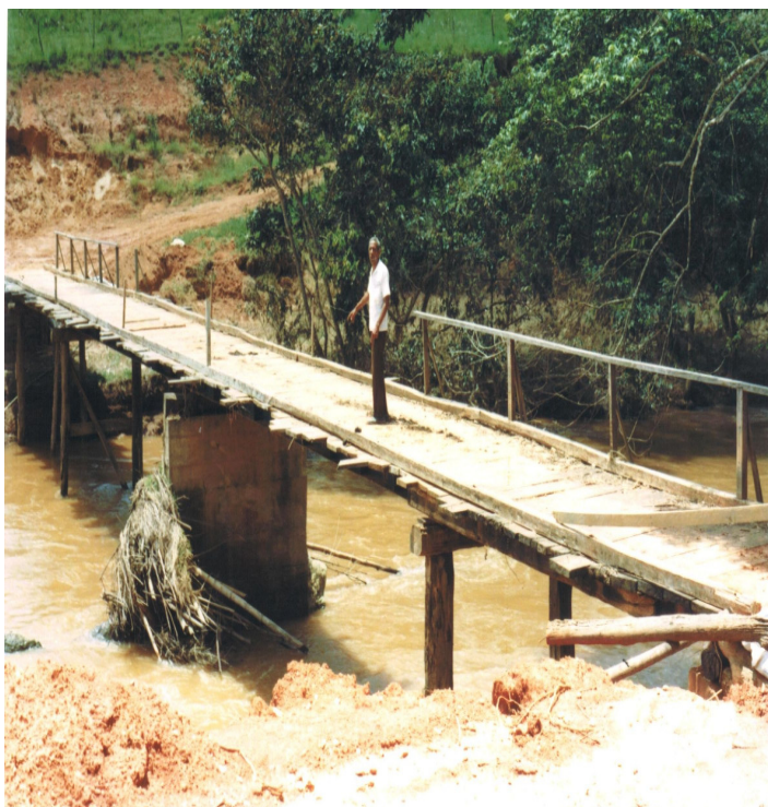
Figura 39: Construção da Ponte de Madeira na Localidade de Morro (zona rural) no final da década de 1990. Esta ponte foi levada durante a inundaç o de 2008, encontra-se em processo de licita o, verba liberada de R$ 350.000 pela SETOP.
