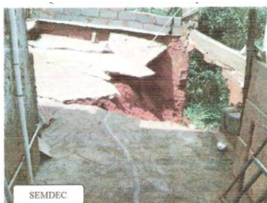
Figura 16 – Queda de Muro – Nova Viçosa
