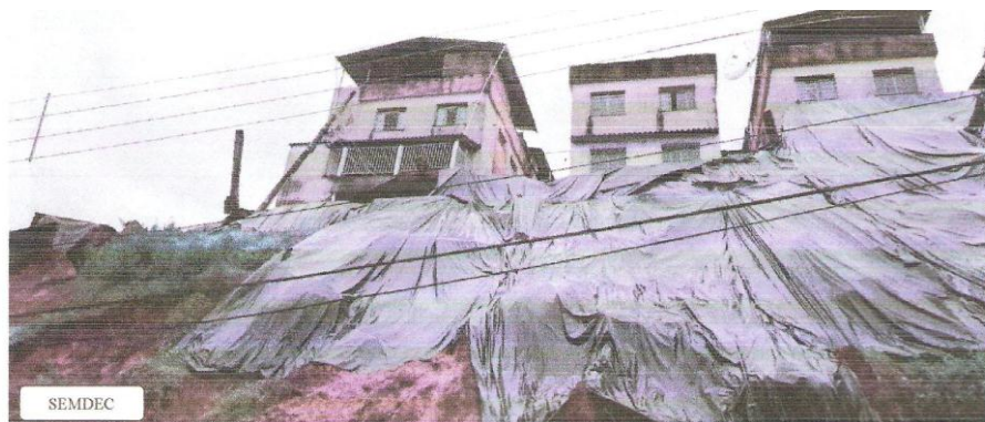
Figura 13 – Residências Interditadas – Travessa do Castelo
