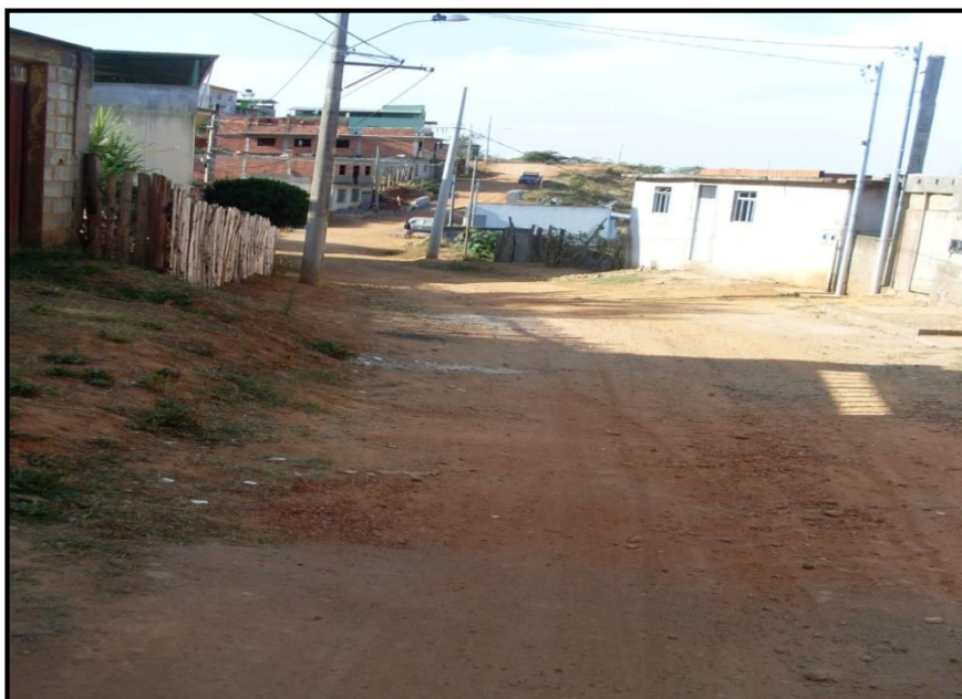
Figura 20: Rua do Bairro Santa Clara sem pavimentação.
