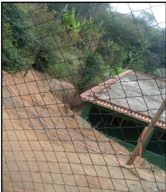
Figura 18: Moradia localizada logo abaixo de encosta.
