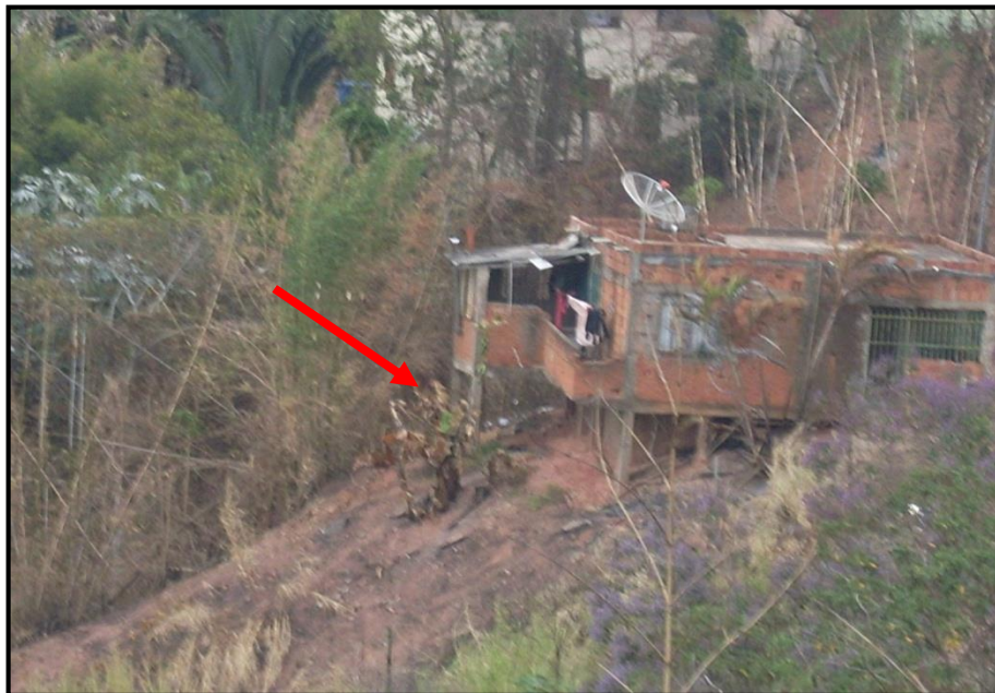
Figura 17: Moradia em área de risco, encosta com pouca presença de vegetação.
