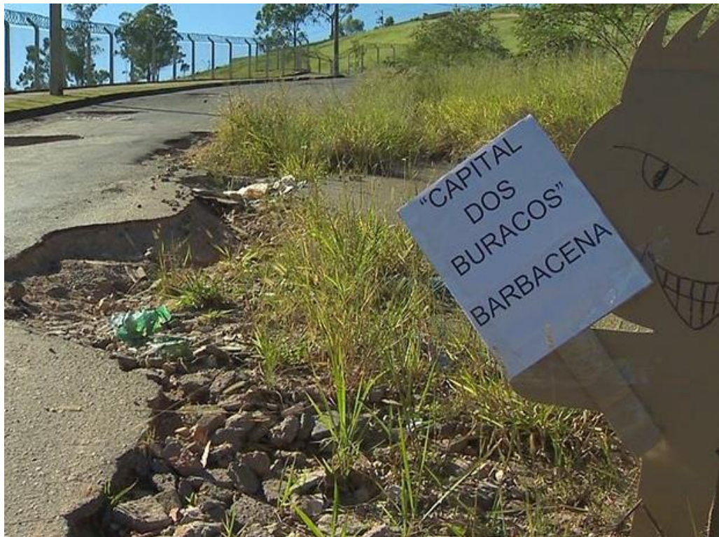
Figura 6 - Buracos por toda a cidade, 2015
