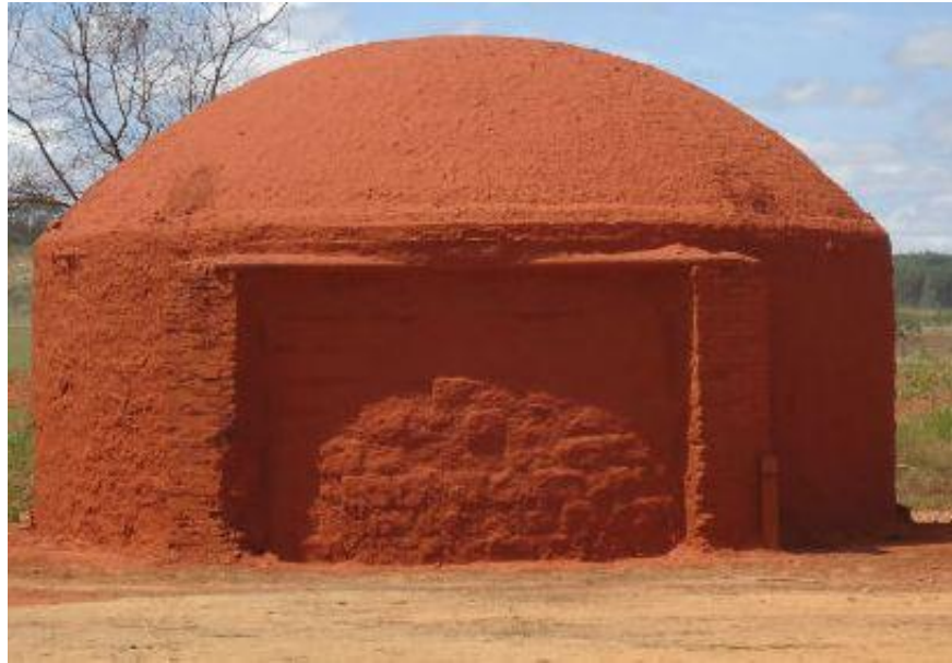
FIGURA 9 – Forno de Superfície (Autoria Própria, 2017; Laboratório de Painéis e Energia da Madeira – Viçosa/MG)
