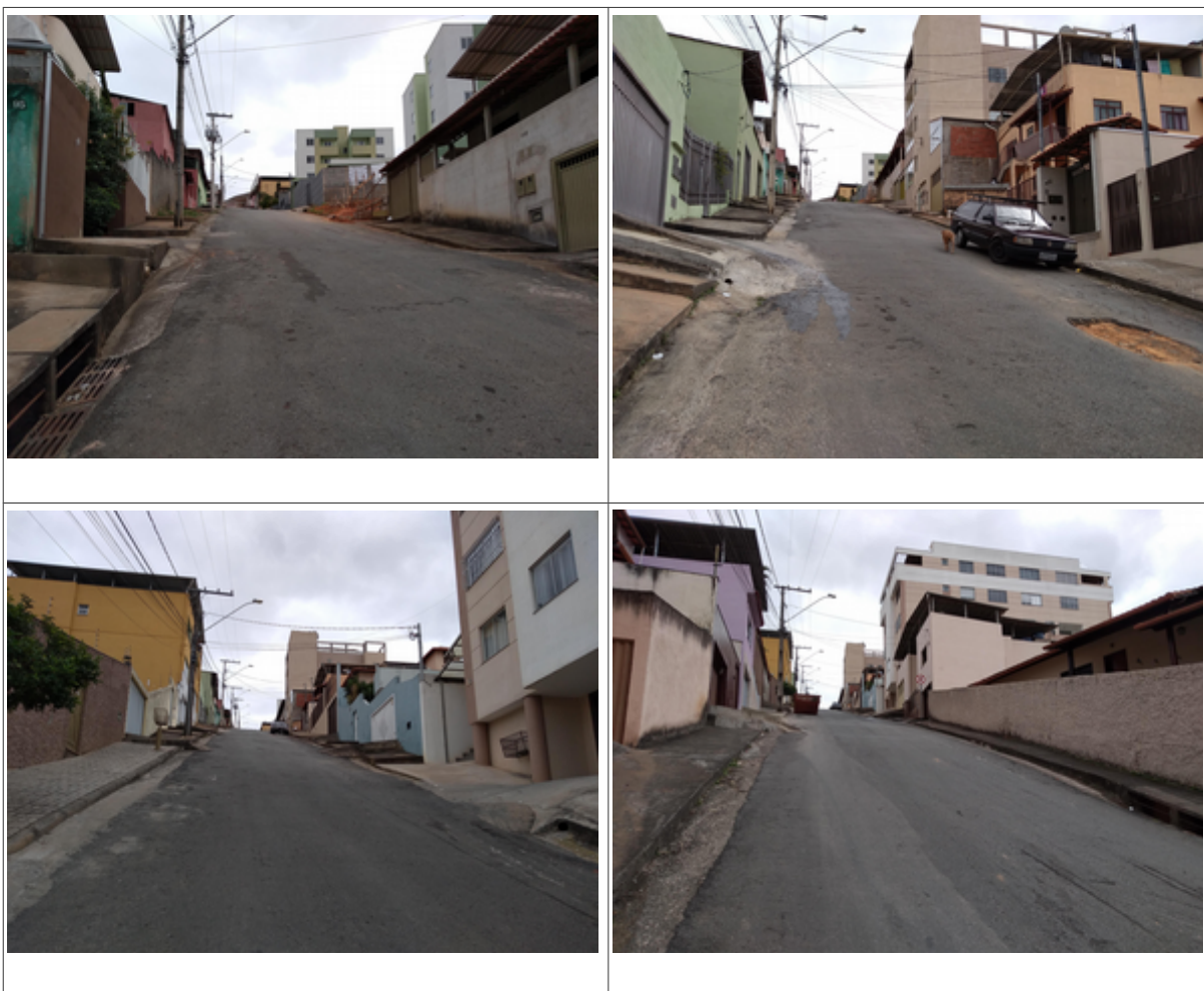
Quadro 3: Desníveis das calçadas de pedestres da Rua Goiânia
